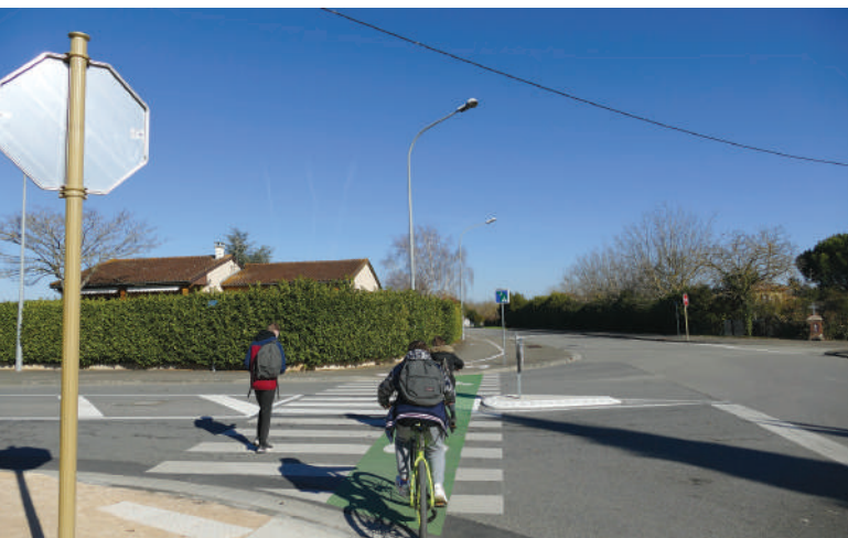
Avenue Vincent Auriol, réception des travaux en janvier 2022 : îlot central, passage piétons et voie cyclable matérialisés.
