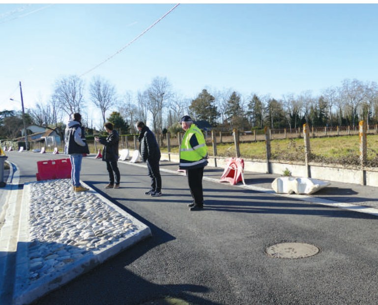
Janvier 2022, réception du chantier chemin de la Dourdouille. Mise en place d'un système d'écluse permettant le ralentissement des véhicules.
