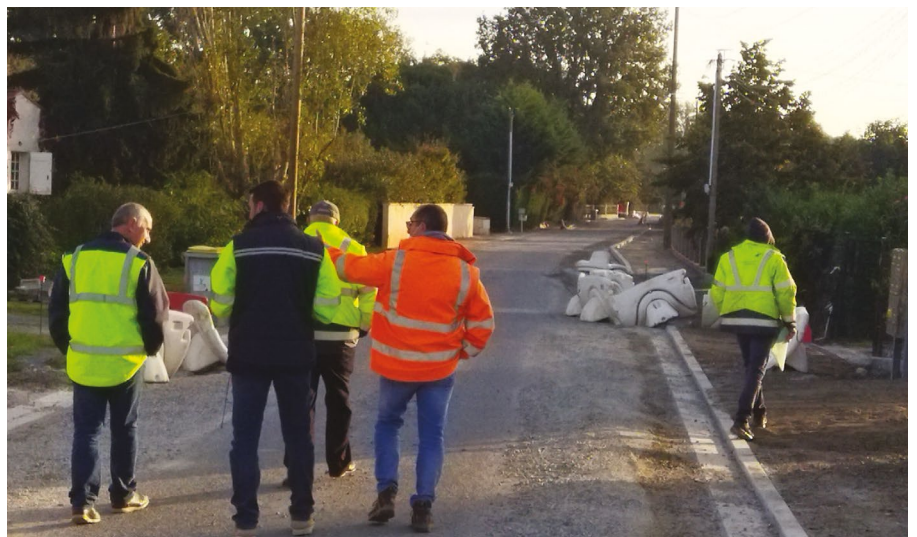
Octobre 2021 : réunion de chantier en présence des techniciens de la CCV, de la mairie et de l'entreprise en charge des travaux.
