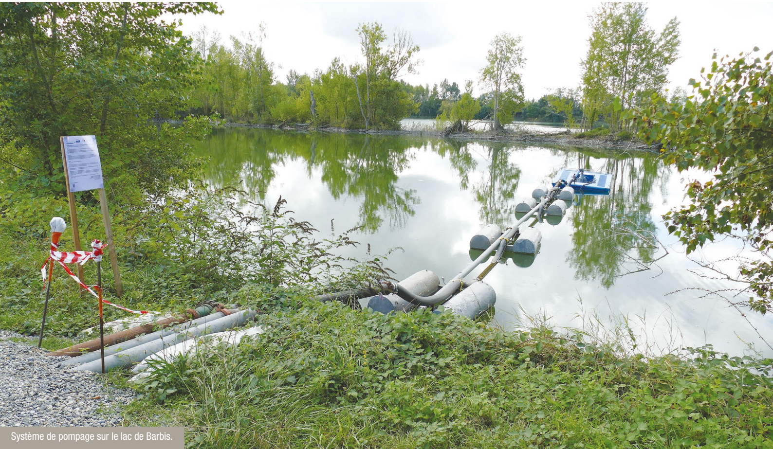
Visite des installations de pompage au lac de Barbis par les acteurs du projet.
