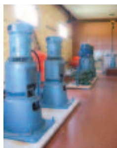
Station de traitement.
