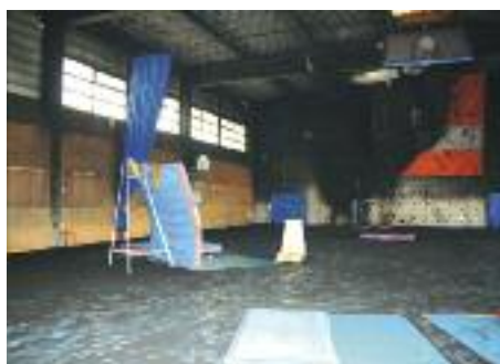
Intérieur du gymnase après l'incendie.
