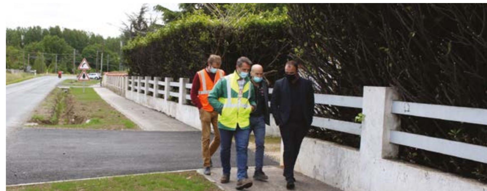
Réception des travaux, route de Longages, par Rémi Ramond, adjoint aux travaux et à l'urbanisme, et Guy Lourde (service des réseaux municipaux) : chaussée en grave-émulsion, passages en enrobé et engazonnement.
