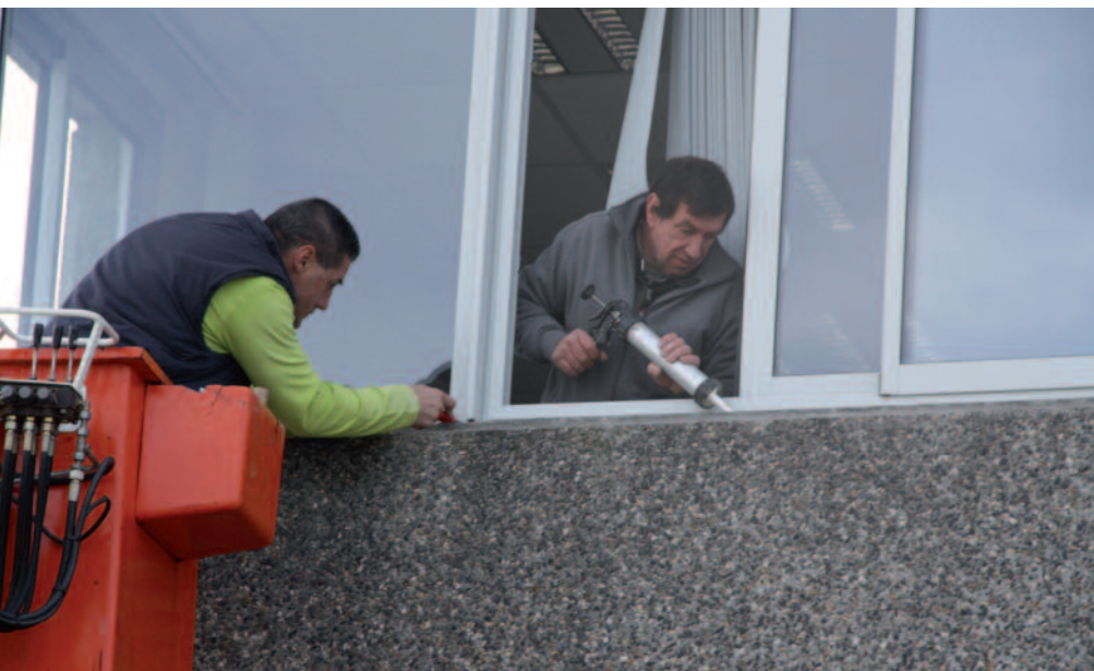
Travaux en régie : changement des menuiseries au centre technique municipal par Jean-Michel et Gilles du service second œuvre bâtiments.
